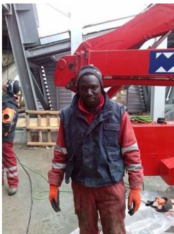
Jean Paul Sene al cantiere sul Monte Bianco (foto funivie Monte Bianco)
